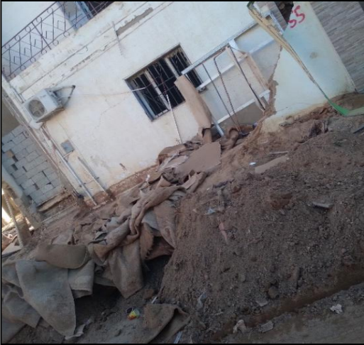
صورة (11) تظهر مبنى سكني وانهيار أحد شرفات المنزل
