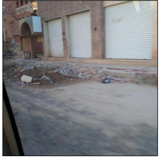
صورة (1) مبنى تجاري تعرض جزء منه للهدم بسبب الفيضان
