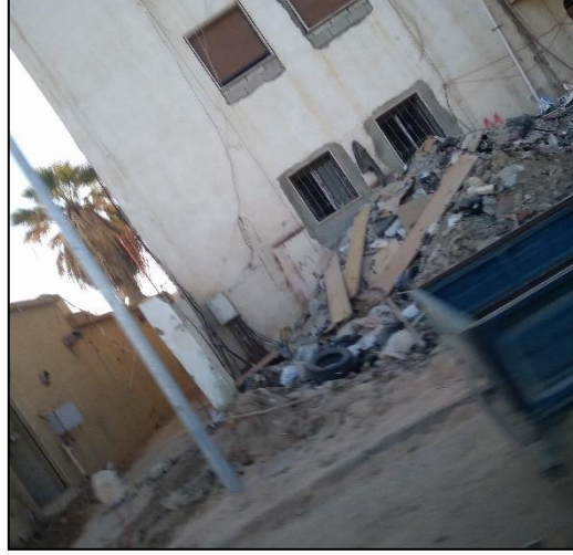
صورة (9) المباني المتضررة بشكل كبير حيث انهارت أساساتها
