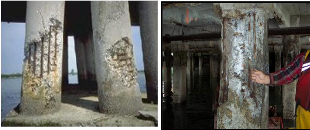
الشكل (8.12) صدأ حديد التسليح نتيجة الكلوريدات
